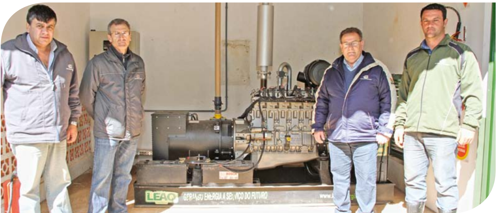
Diretores estiveram conferindo funcionamento dos geradores
