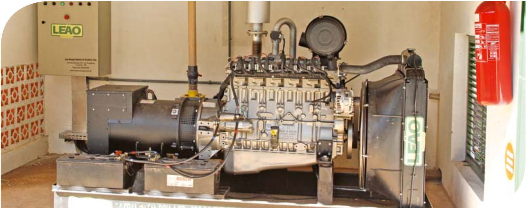
Três geradores foram instalados na Granja Ibicuí
